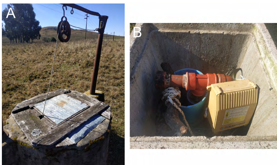
Figura 4. Tipos de captaciones de agua subterránea en la ciudad de Minas. A. Pozo con brocal. B. Pozo en tubería PVC.
