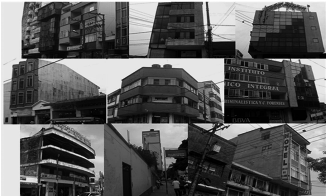
FIGURA 9. Fotografías que muestran algunos ejemplos de las malas condiciones estructurales y de sismo resistencia en algunos de los edificios del centro de la ciudad, como la colindancia entre los edificios de la fotografía de la esquina superior izquierda. Igualmente se observan aquí casos como la falta de reforzamiento estructural, fachadas en voladizo y geometría irregular con escalonamientos o retrocesos. Con estos ejemplos es claro que la vulnerabilidad frente a un sismo se incrementa de manera dramática para Villavicencio.
