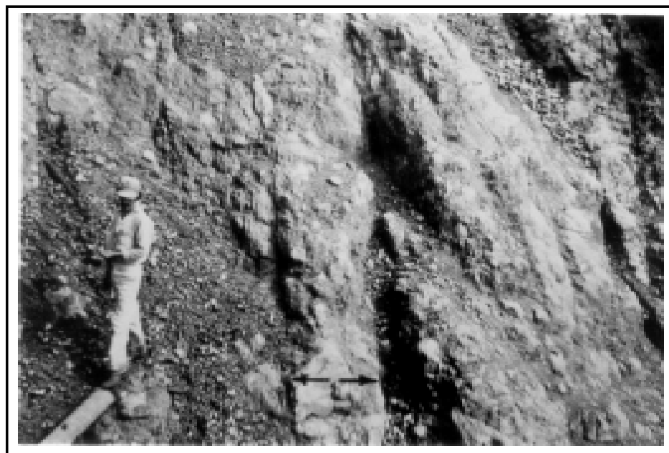
FIGURA 3. Aspecto del sector central de la brecha pipe sobre el canalón central, a la altura de la bocamina de Antonio Hernández. El sistema de fracturas señalado con las flechas presenta una orientación N30°W. Foto tomada en dirección NE.
