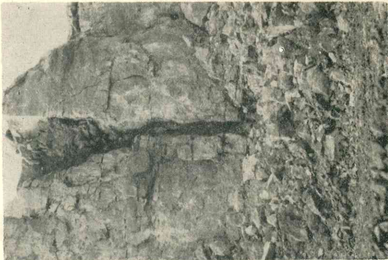
FOTO 2.—Vista parcial de la misma grieta.
