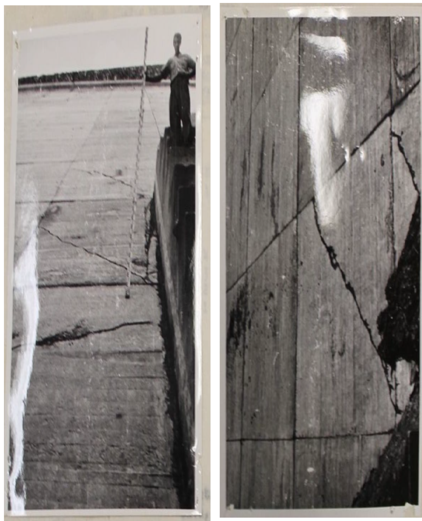
Figura 6. Fotografías de las grietas.
