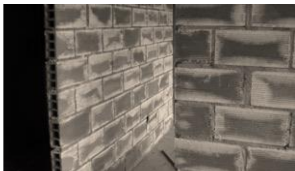
Figura 1. Presencia de eflorescencias en sistemas de mampostería. Fuente: elaboración propia.
