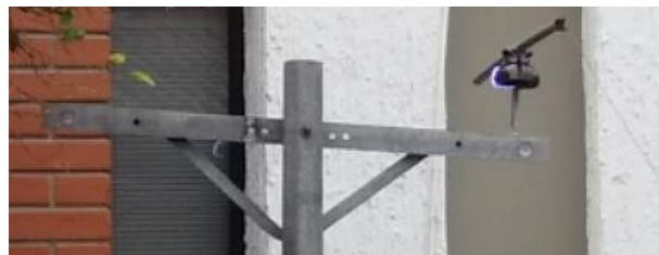
Figura 5. Flameo en seco. Estructura compuesta por poste y cruceta de acero. Fuente. Elaboración propia.
