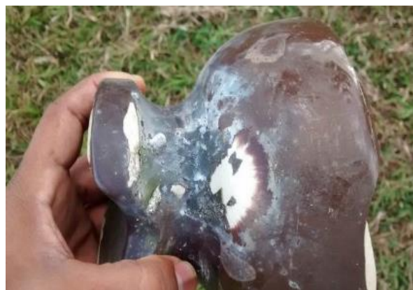
Figura 2. Falla de un aislador ANSI 55-4 causado por DA en RD de 13.2 kV. Fuente. Elaboración propia.
