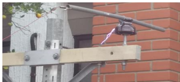
Figura 6. Flameo en seco. Estructura compuesta por poste y cruceta de PRFV con diagonales metálicas. Fuente. Elaboración propia.
