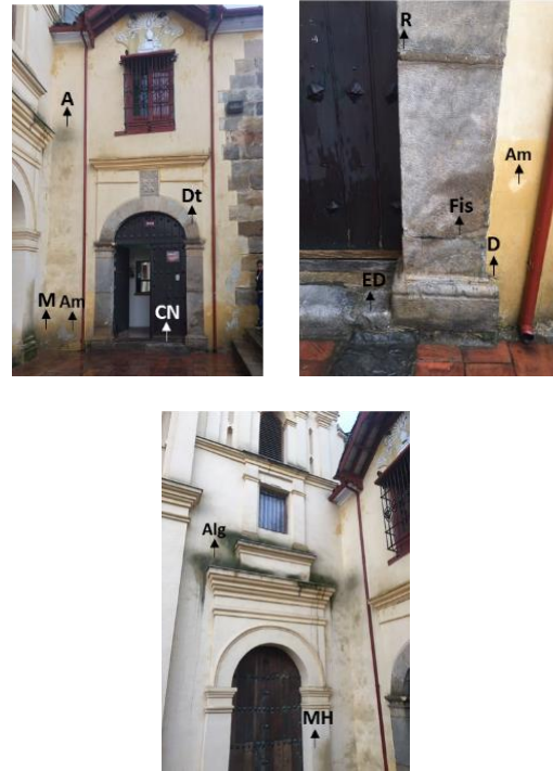
Figura 5. Identificación de procesos patológicos en la PM utilizada en la fachada de la Iglesia de la Candelaria en Bogotá, Colombia. Fisuras (Fis), ampollas (Am), redondeamiento (R), erosión diferencial (ED), alteración cromática como costra negra (CN), mancha de humedad (MH) y colonización biológica de algas (Al). Fuente: elaboración propia.
