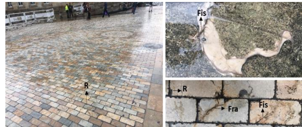
Figura 7: Formas de deterioro en la MRB utilizada en el sendero peatonal de la carrera séptima desde la Plaza de Bolívar hasta Av. Jiménez en Bogotá, Colombia. Fisuras (Fis), fracturas (Fra) y redondeamiento (R). Fuente: elaboración propia.
